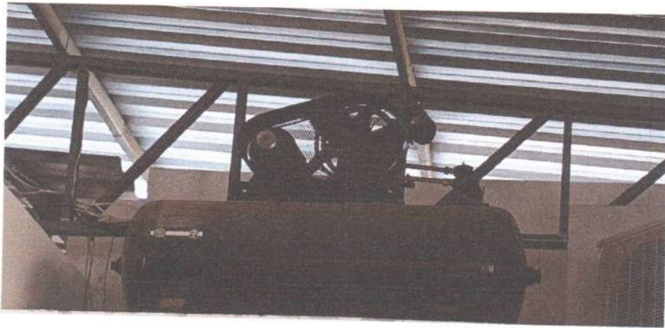
Compressor de Ar:
